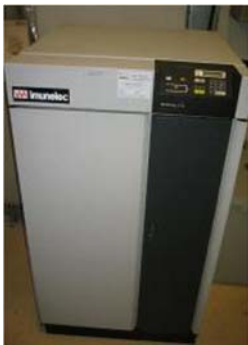
ASI statique au CH Compiègne (30kVA)
